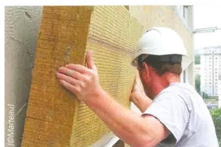
L'isolation a été assurée par une laine de roche de 16 cm d'épaisseur, obligatoire en IGH par rapport aux risques de propagation d'incendie.
